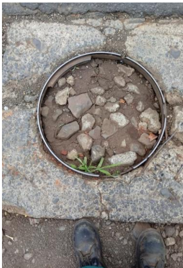
Figura 41: Av. Santa Catarina esquina com rua Pernambuco com PV coberto.
