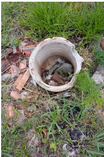
Figura 43: Ligações danificadas na rua Rio Grande do Sul.
