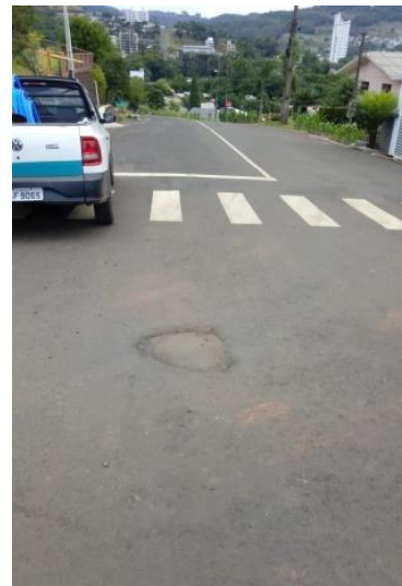
Figura 42: Rua Alagoas com PVs cobertos com asfalto.
