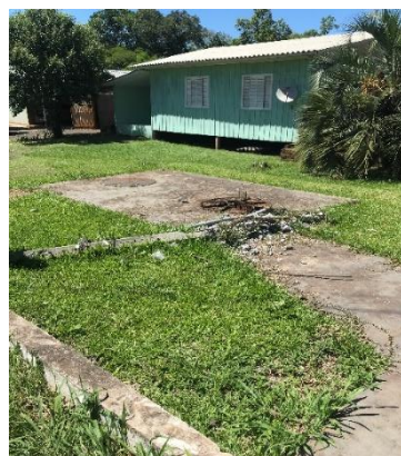
Figura 46: Poste do quadro de comando da EEE destruído.
