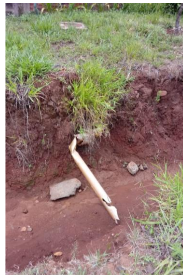
Figura 44: Ligações danificadas na rua Sergipe.
