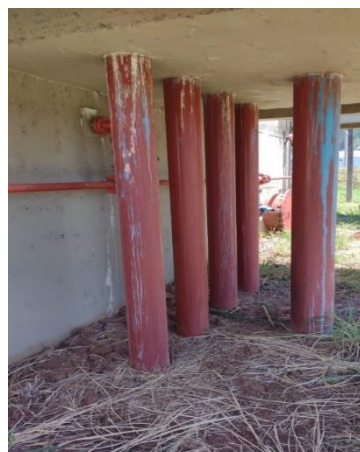
Figura 48: Tubulações que não correspondem com o que havia no projeto, tanto no DN como em material inferior ao pedido.
